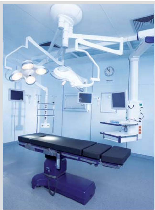
Centro cirúrgico ALPHA-PORT com distribuidor 800 e sistema multimídia SATELITE, equipado com focos da série HANAULUX 3000, suporte para tela plana e suporte para anestesia de infusão.
